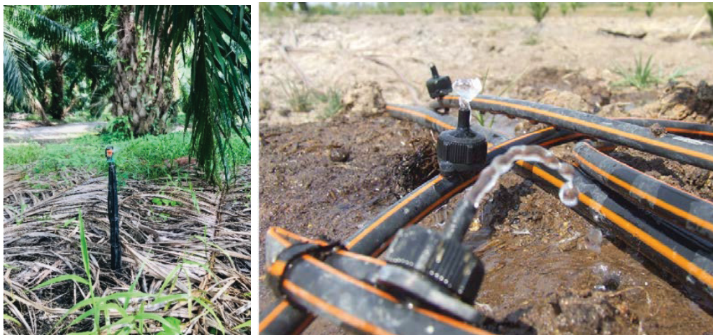
ภาพที่ 25 ระบบน้ำหยด/มินิสปริงเกอร์ในแปลงปาล์มน้ำมัน
