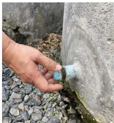
ภาพที่ 1 ท่อระบายน้ำแบบมีฝาปิด เพื่อบังคับระดับน้ำในบ่อ
