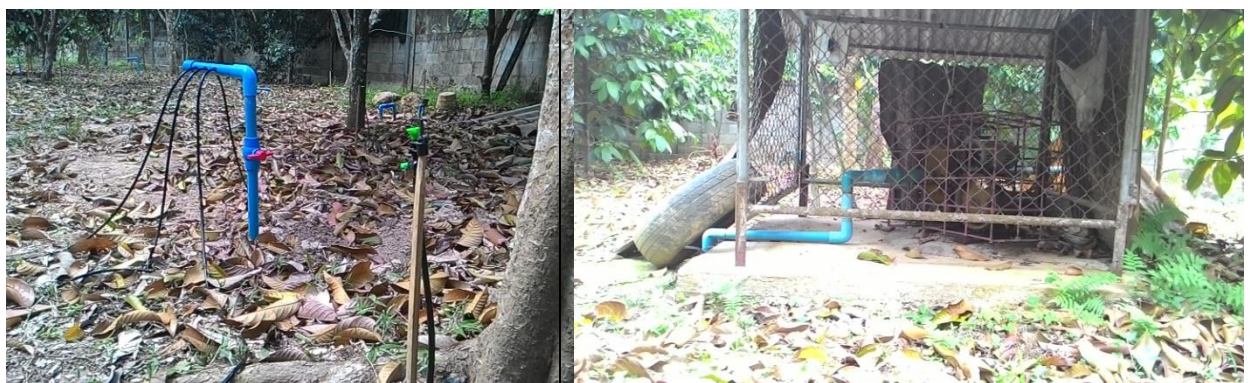
ภาพที่ 20 การติดตั้งระบบน้ำในรูปแบบสปริงเคลอร์
