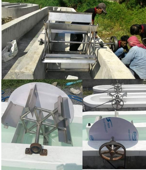
ภาพที่ 10 แสดงการติดตั้งระบบบำบัดของบ่อเพาะเลี้ยงสาหร่ายขนาดเล็ก
