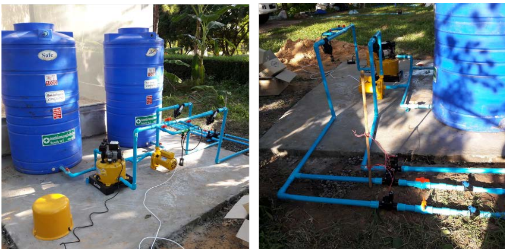
ภาพที่ 20 ชุดปั้มน้ำสำหรับระบบน้ำหยด และระบบพ่นหมอก
