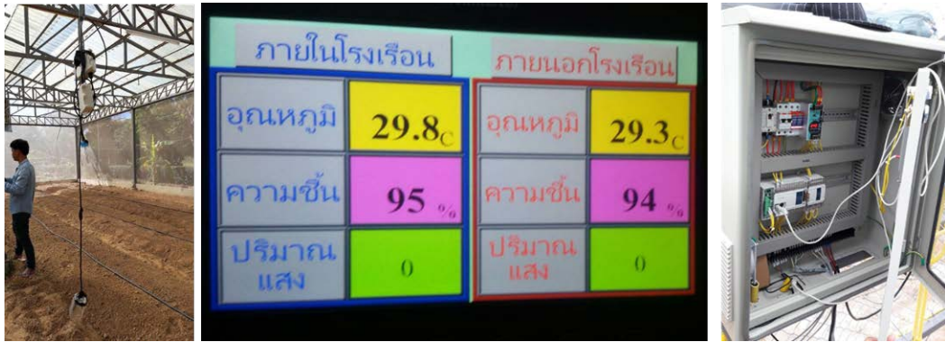
ภาพที่ 17 การใช้ระบบการควบคุมแบบ PLC (Programmable logic controller)
