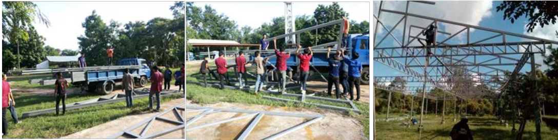
ภาพที่ 6 การขนย้ายและประกอบติดตั้งชิ้นส่วนโครงสร้างโรงเรือนตามแบบ ณ สวพ.4
