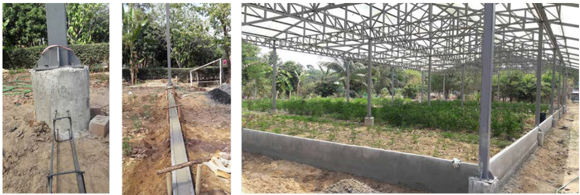
ภาพที่ 12 เทคนิคการก่ออาบอิฐบล็อกสูง 2 ก้อนอิฐบล็อก รอบโรงเรือน
