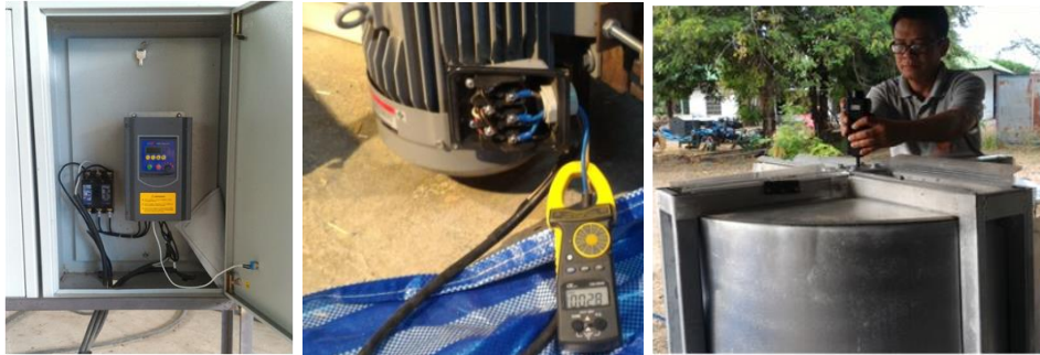
ภาพที่ 19 อุปกรณ์ปรับความเร็วมอเตอร์ขับ การใช้เครื่องมือวัดกระแสไฟฟ้า และการใช้อุปกรณ์วัดความเร็วรอบเพลลา
