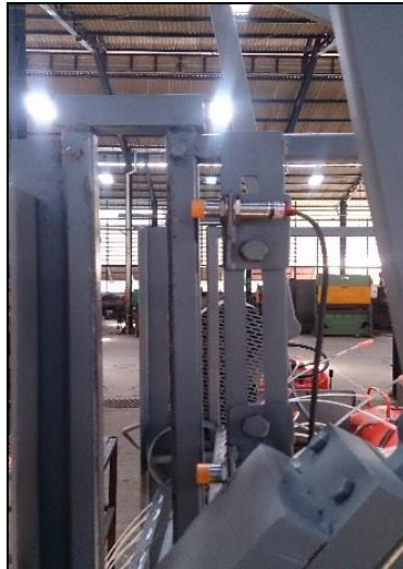
รูปที่ 14 การติดตั้ง Proximity sensor กำหนดระยะเลื่อนขึ้นลงของลูกปัด
