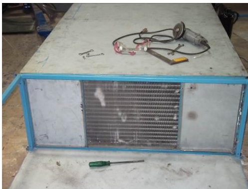
รูปที่ 12. แผงคอยล์คอนเดนเซอร์
