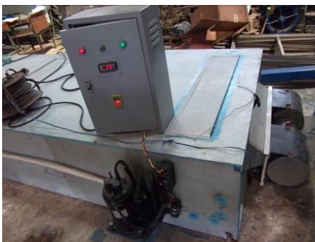
รูปที่ 16. ตู้ควบคุม
