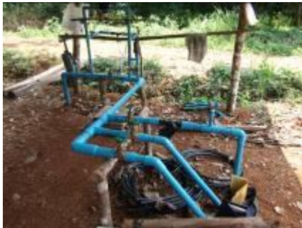
รูปที่ 12 ท่อจ่ายน้ำหลักเข้าแปลงมังคุดทดลอง
