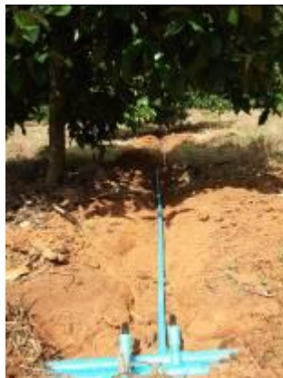
รูปที่ 14 ท่อจ่ายน้ำเข้าต้นมังคุด
