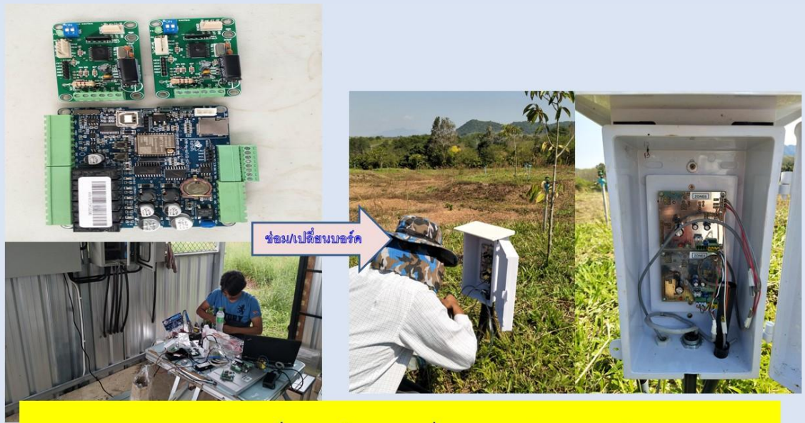
การซ่อมแซม/เปลี่ยนบอร์ดควบคุมที่เกิดความเสียหายจากฟ้าผ่า
