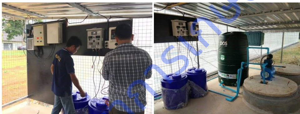
ภาพที่ 2.2 ติดตั้งชุดทดสอบการควบคุมระบบจ่ายปุ๋ยแบบอัตโนมัติ
