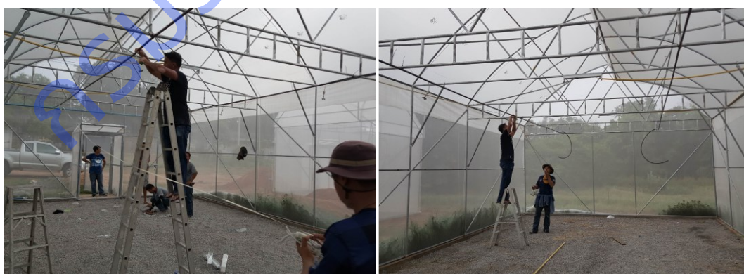
ภาพที่ 2.1 การติดตั้งหัวพ่นหมอกในโรงเรือน
