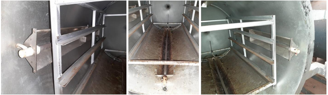
ภาพที่ 1.17 การติดตั้งฮีตเตอร์สำหรับระบบให้ความร้อน 4 ด้าน ของถังอบแห้ง
