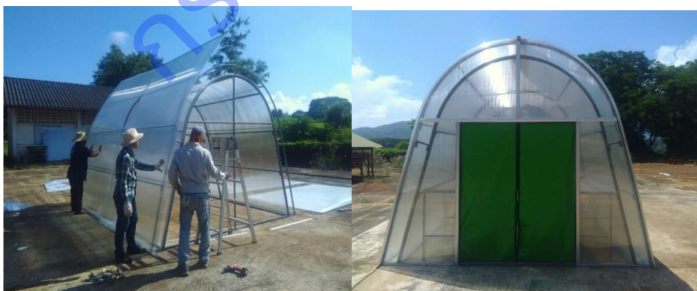
ภาพที่ 2.1.14 แสดงโรงตากทรงหลังคาโค้ง ที่ทำการประกอบพร้อมติดตั้งกับอุปกรณ์แผงโซลาร์เซลล์ อุปกรณ์ เก็บพลังงานแสงอาทิตย์ที่จัดเตรียมไว้ใช้รวมทั้งเชื่อมต่อกับพัดลมดูดอากาศ และอุปกรณ์วัดอุณหภูมิภายในโรง ตาก เพื่อใช้ทดสอบประสิทธิภาพการลดความชื้นเมล็ดพันธุ์ถั่วเหลืองในฤดูฝนนี้ต่อไป
