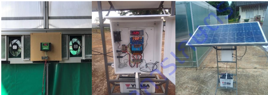
ภาพที่ 13 แสดงอุปกรณ์วัดอุณหภูมิภายในโรงตาก ที่เชื่อมต่อกับพัดลมดูดอากาศ และแผงโซลาร์เซลล์ที่ใช้เป็นแหล่งพลังงานให้กับระบบอิเล็กทรอนิกส์ต่างๆที่ใช้กับโรงตาก เพื่อควบคุมอุณหภูมิภายในโรงตาก ไม่เกิน 42-45 องศาเซลเซียส
