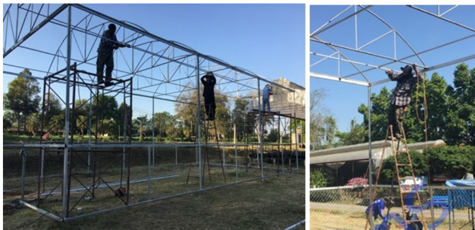
ภาพที่ 10 การติดตั้งโครงเหล็กสำหรับการติดตั้งระบบไฟฟ้าแสงสว่าง
