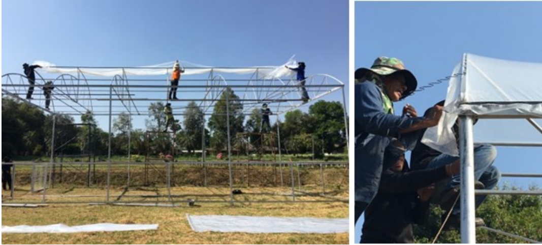
ภาพที่ 7 การติดตั้งพลาสติกมุงหลังคาโรงเรือน
