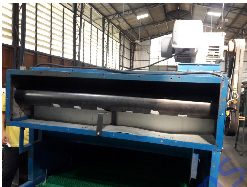
ภาพที่ 26 ติดตั้งอุปกรณ์ให้ความร้อนแบบฮีทเตอร์ไฟฟ้าภายในตัวเครื่อง
