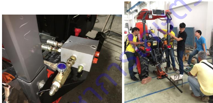
(2) ติดตั้งชุดควบคุมอัตราการไหลของน้ำมันไฮดรอลิก
