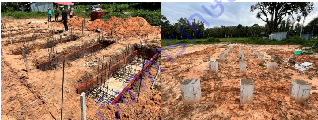
ภาพที่ 1.3 ฐานต่อม่อสำหรับรองรับห้องทดลองปลูกพืชแบบตู้คอนเทนเนอร์
