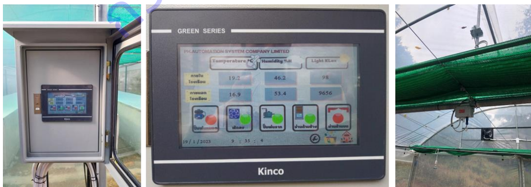
ภาพที่ 3.10 ตู้ควบคุมและชุดเซ็นเซอร์
