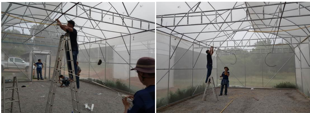
ภาพที่ 1 การติดตั้งหัวพ่นหมอกในโรงเรือน
