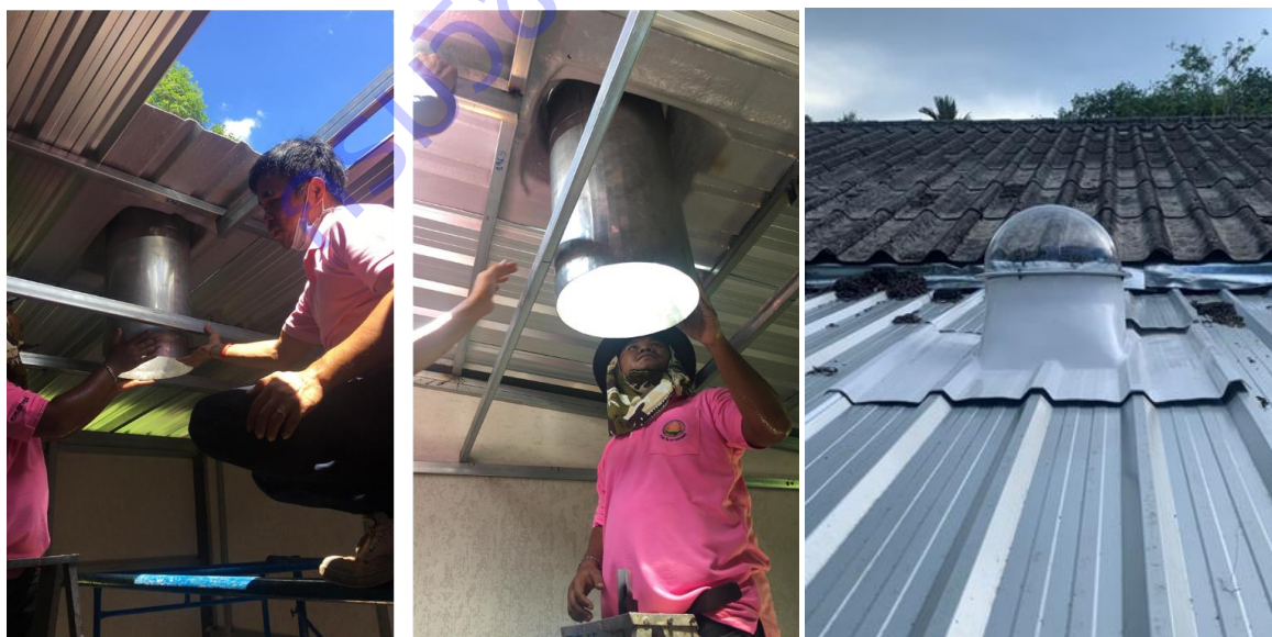
ภาพที่ 2.4 การติดตั้งท่อนำแสงผ่านหลังคาเข้าในตัวอาคารห้องทดลอง
