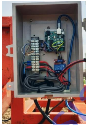
ภาพที่ 2 ตู้ควบคุมระบบวัดระยะห่างระหว่างหลุมปลูกกล้วยแบบอัตโนมัติ
