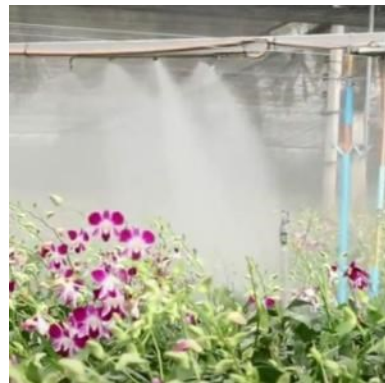
ภาพที่ 3.2.5 ระบบพ่นสารเคมีแบบแปรผันอัตราได้ที่ติดตั้งในโรงเรือน
