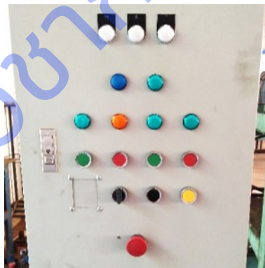
ภาพที่ 3.1.3 ตู้ควบคุมด้วย PLC
