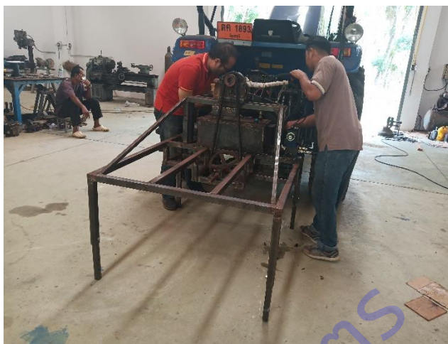
ภาพที่ 20 ติดตั้งปั้มน้ำมันไฮดรอลิกสำหรับขับเคลื่อนกำลังมอเตอร์ไฮดรอลิก
