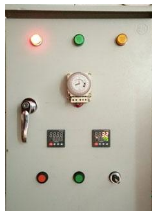
ภาพที่ 33 ตู้คอนโทรลแบบใช้หัวสปาร์คด้วยไฟฟ้าจุดหัวเผา และตั้งเวลาตัดต่ออุณหภูมิเป็น 2 ช่วงเวลา
