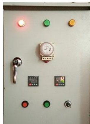
ภาพที่ 31 ตู้คอนโทรลแบบใช้หัวสปาร์คด้วยไฟฟ้าจุดหัวเผา และตั้งเวลาตัดต่ออุณหภูมิเป็น 2 ช่วงเวลา
