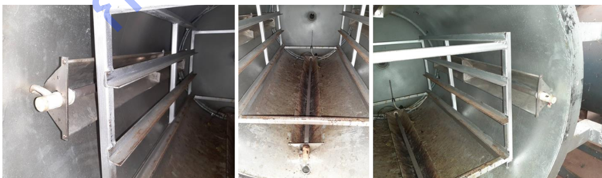
ภาพที่ 4.7 การติดตั้งฮีตเตอร์สำหรับระบบให้ความร้อน 4 ด้าน ของถังอบแห้ง
