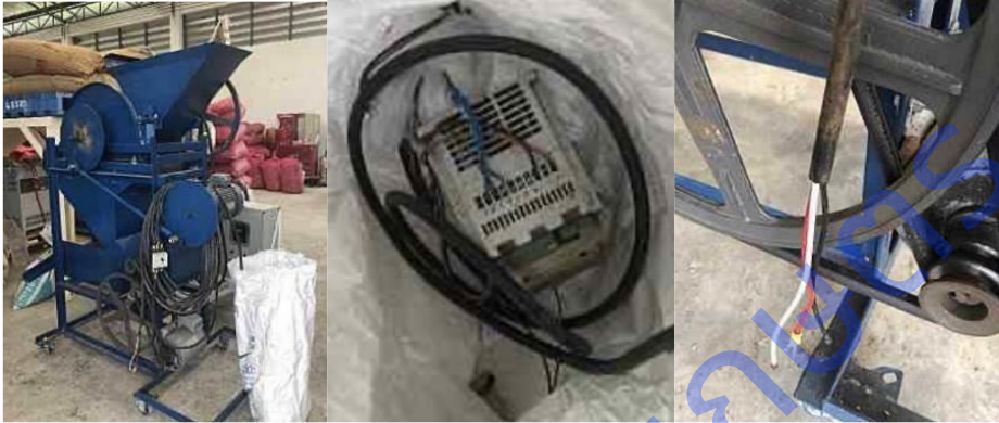
ภาพที่ 2.4 ระบบไฟฟ้าของเครื่องกะเทาะฝักถั่วลิสงพร้อมระบบทำความสะอาดชำรุดไม่สามารถใช้งานได้
