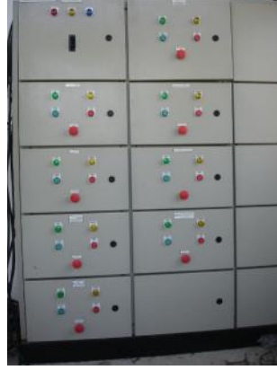
ภาพที่ 7 ตู้เมนบอร์ดและการติดตั้งระบบไฟฟ้าที่ต้องใช้ในกระบวนการผลิตไบโอดีเซลแบบครบวงจร
