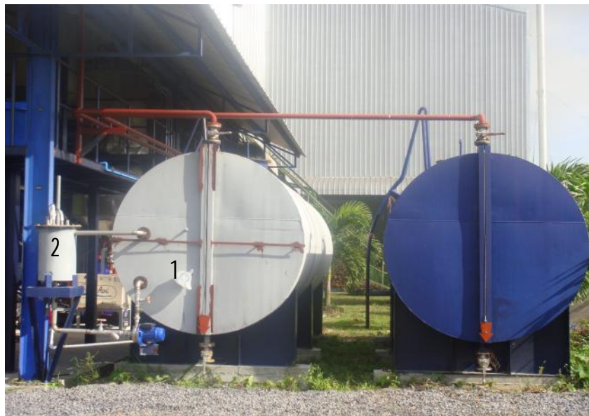
ภาพที่ 2 (1) ถังบรรจุวัตถุดิบกลีเซอรินขนาด 15,000 ลิตร และ (2) เครื่องควบคุมอุณหภูมิ Thermal oil
