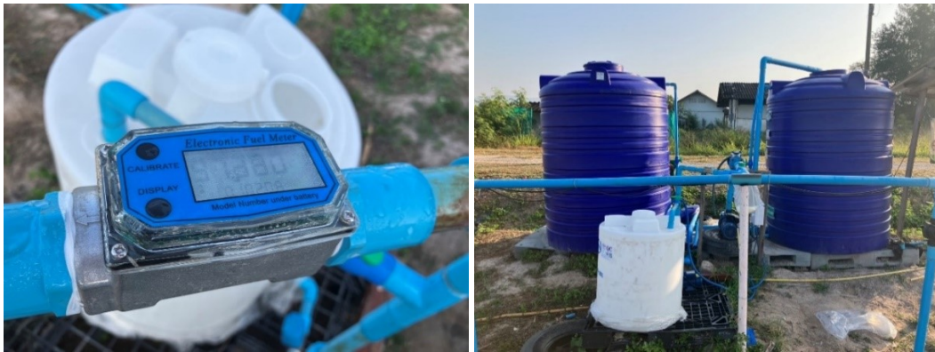
รูปที่ 11 การติดตั้งระบบการให้ปุ๋ยร่วมกับระบบน้ำโดยใช้ระบบกระจายปุ๋ยแบบอัตโนมัติ
