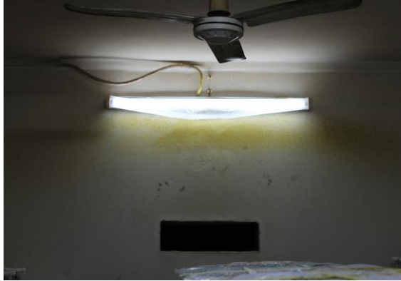
ภาพที่ 3.4 การติดตั้งหลอดไฟในตำแหน่งที่ไม่เหมาะสมใกล้กับช่องปล่อยก๊าซ
