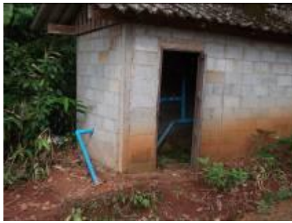
รูปที่ ๑๐. ห้องจ่ายน้ำเข้าแปลงทดลอง
