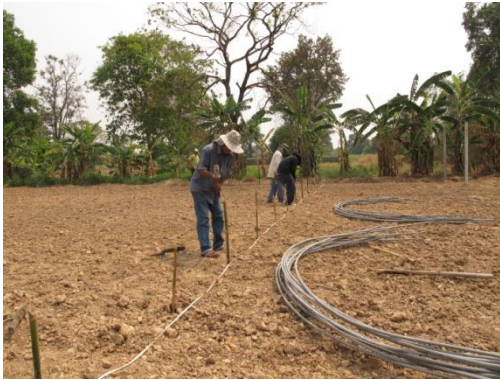
รูปที่ ๑๑ วัดระยะและกำหนดตำแหน่งเสาโรงเรือน
