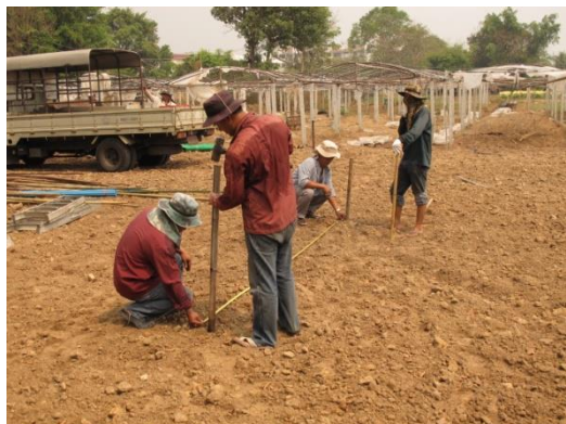
รูปที่ ๑๙ วัดระยะและกำหนดตำแหน่งเสาโรงเรือน
