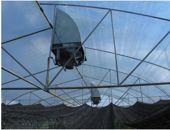
ก. พัดลมที่ติดตั้งพร้อมแผ่นบังลม
