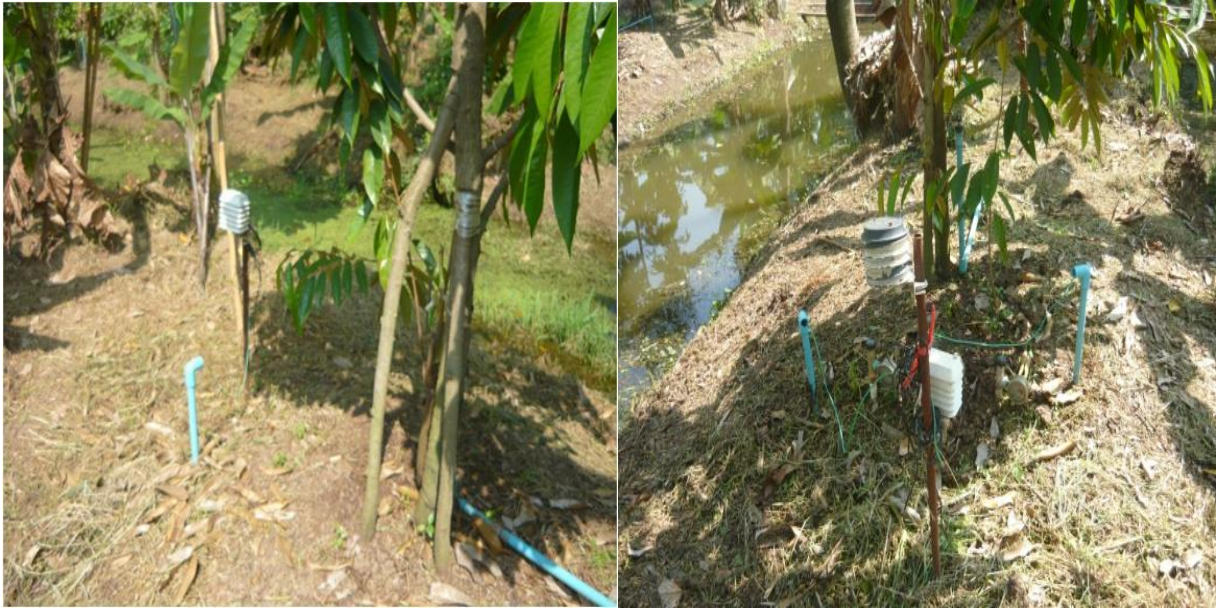
ภาพที่ ๕ ลักษณะการติดตั้ง WatchDog Data Logger
