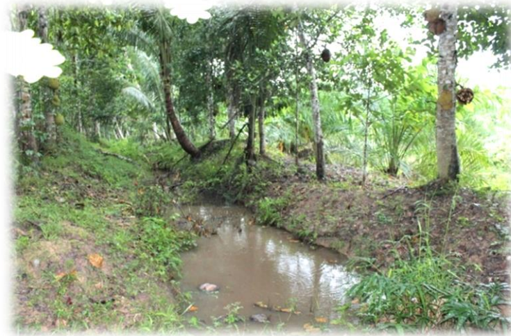
ภาพที่ 53 การขุดร่องเพื่อระบายน้ำและเป็นแนวกันชนทางดิน
